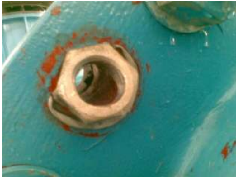
Rajah 18: Kegagalan pada tie rod .
