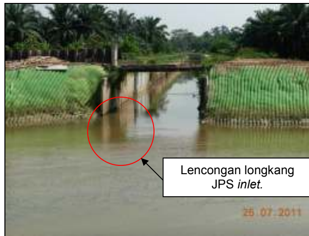
Rajah 21: Inlet bagi lencongan longkong JPS.
