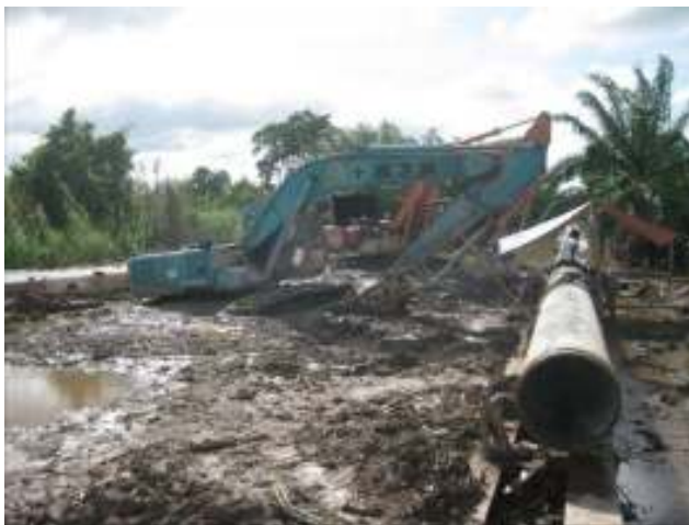
Rajah 15: Berhadapan dengan water table yang tinggi dan tanah lembut.
